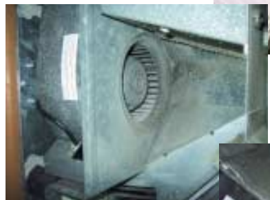
Tilluftsfläkt med smuts
